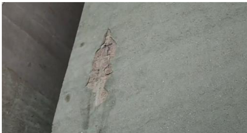
Figura 3: degradare tipică fatada
