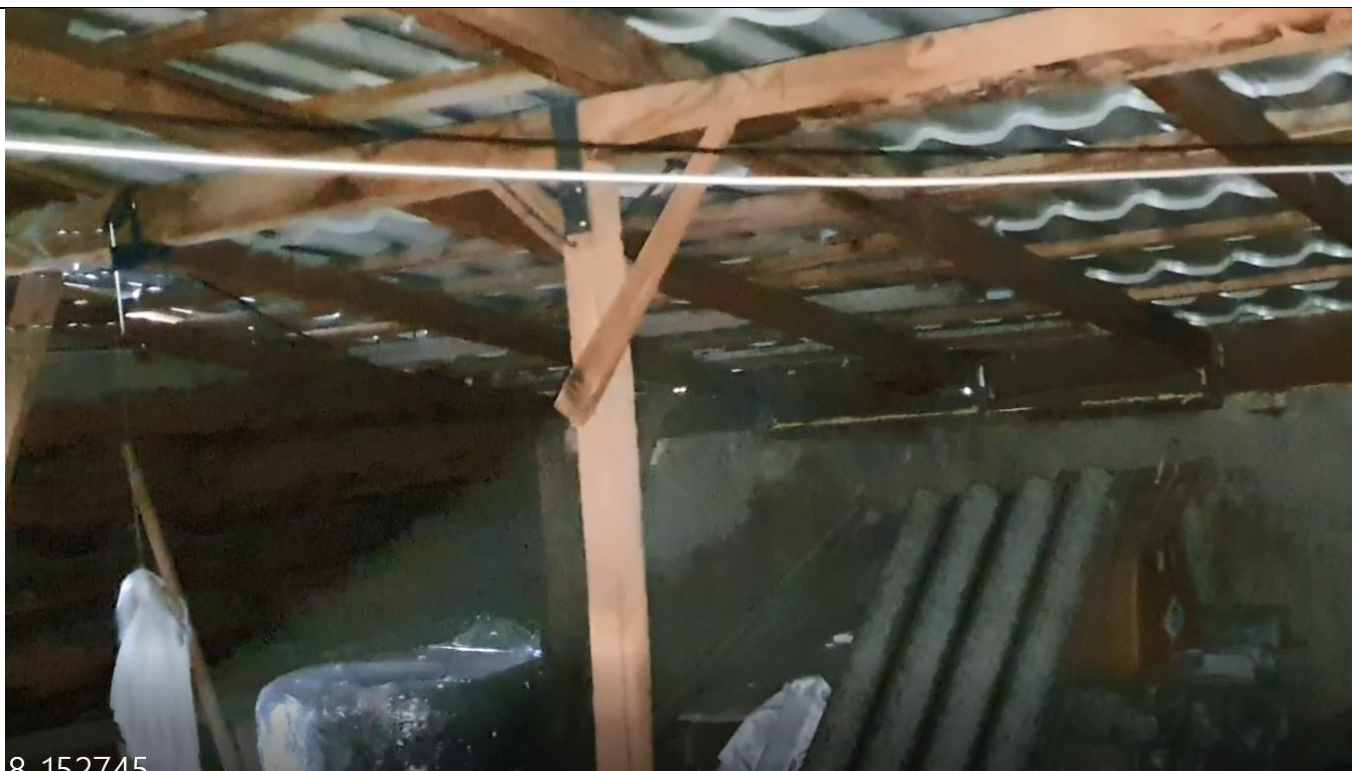
Figura 7: Structura existenta de lemn locală la terasa scara A
