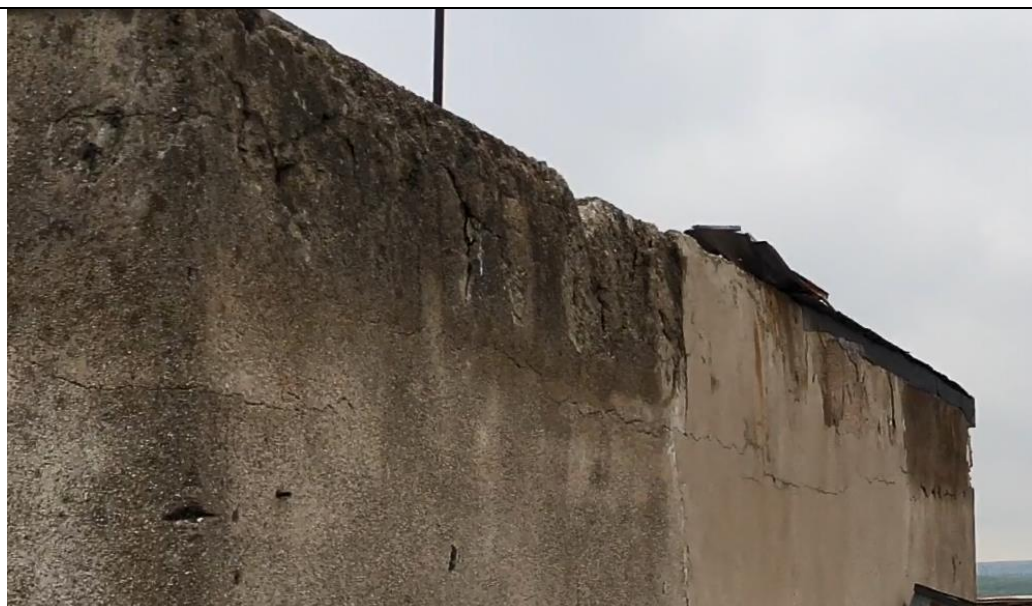
Figura 16: Degradări tipice din eroziune termotehnică
